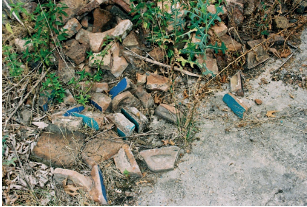
Resim 6. Kusar-Hazra Köyü, Şeyh Cüneyd Türbesi: Kubbe kasnağındaki süsleme kuşağından restorasyon öncesi dökülerek çevreye dağılan sırlı tuğlalardan bazıları (2003).
