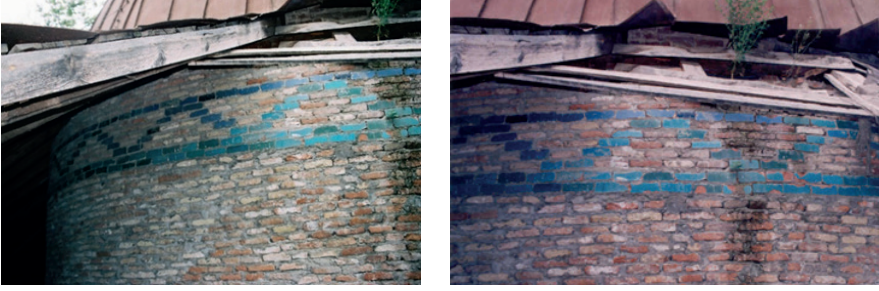
Resim 5. Kusar-Hazra Köyü, Şeyh Cüneyd Türbesi: Kubbe kasnağındaki sırlı tuğla süsleme kuşağının restorasyon öncesi görünümü (2003).
